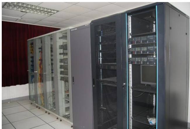
图 3-2 校园数据中心机房
